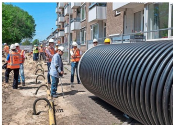
De warmtewisselaar om de buis heeft een spiraalvorm.
