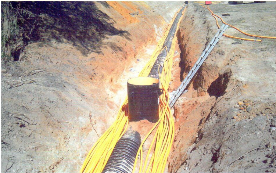
In Heerenveen vindt voor het eerst toepassing plaats van riothermie uit de rioolstreng zelf.
